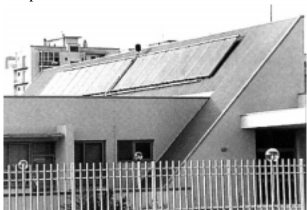
Figura 2.8 - Pannelli su una scuola elementare di Lecce (foto: Costruzioni Solari srl).
