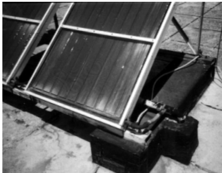
Figura 2.11 - Particolare di uno dei collettori di fig. 2.9 e tubo di mandata della serie.
